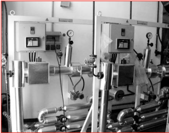
Panoplies vapeur pour l'alimentation du préconditionneur et l'alimentation de l'extrudeur.
